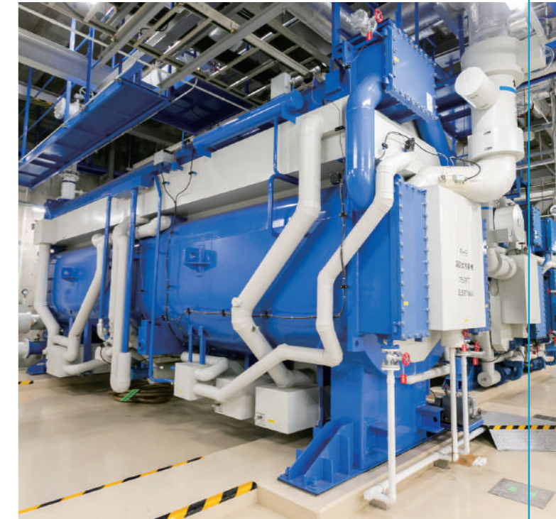
地域冷暖房設備
