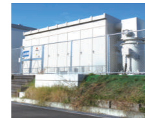
特別高圧受変電設備
