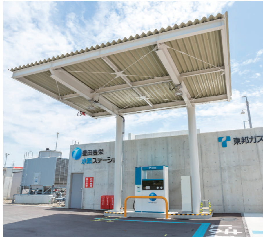
水素ステーション
