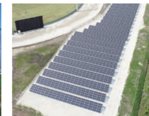
太陽光発電設備
